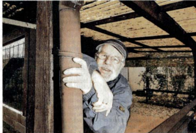
Das Terrassendach im Kleingartenverein „Am Stadionweg“ hätte eigentlich abgerissen werden müssen. Jetzt darf es bleiben, freut sich Schriftführer Dieter Claas.
